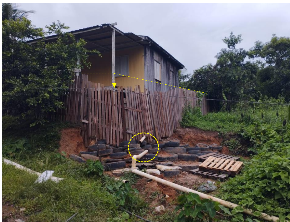
Figura 6 – Moradia com suas estruturas colapsada devido a movimentação do maciço – solapamento com deslizamento.
